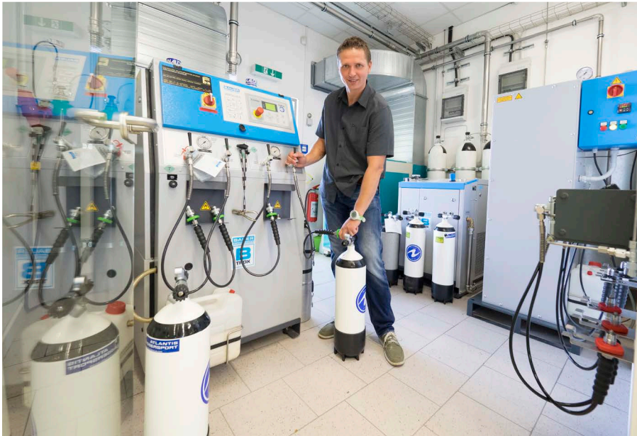
Atlantis Geschäftsführer Christian Wendt beim Füllen aus der BAUER OX Anlage
